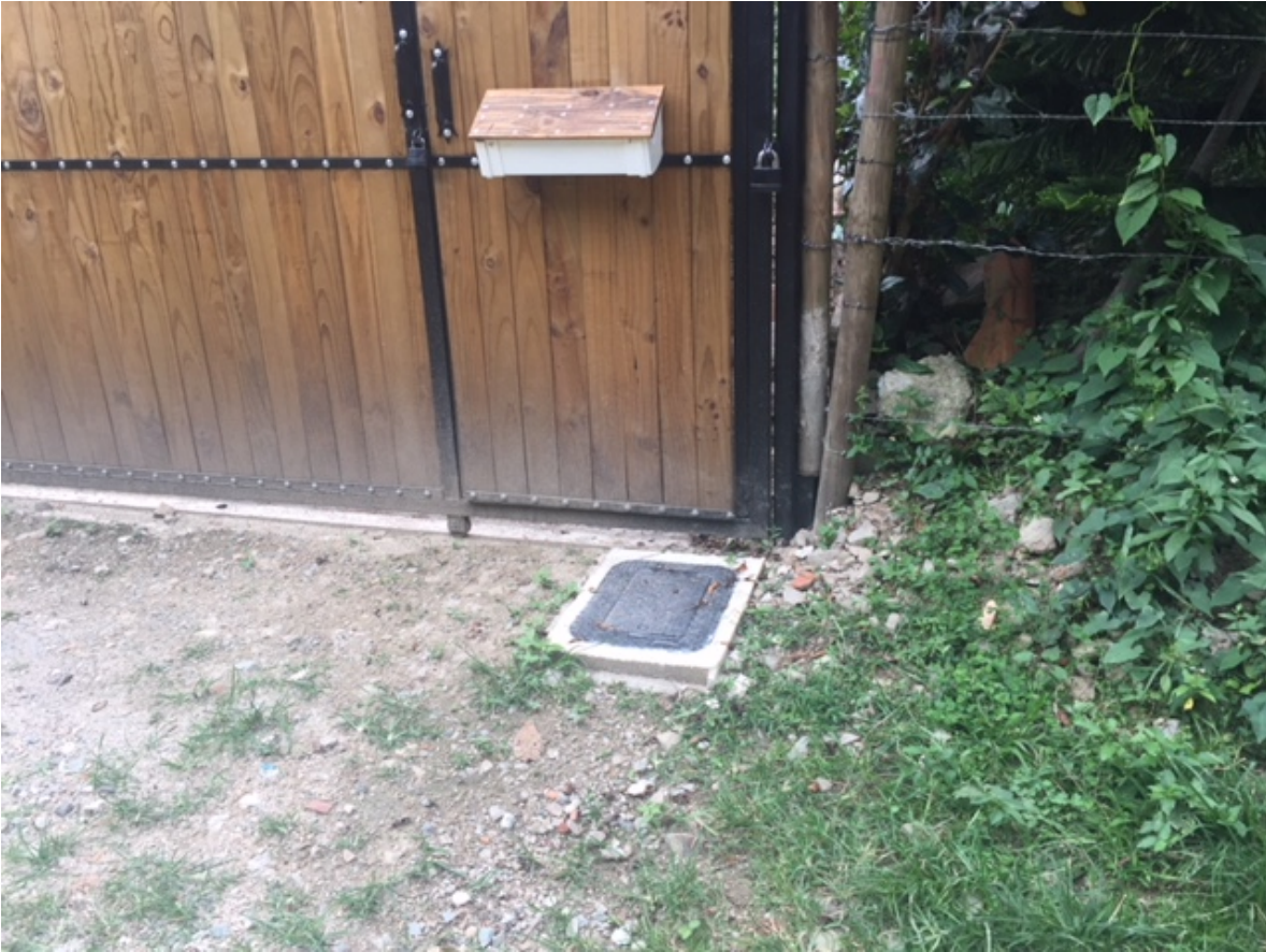
Contador de otra vecina del señor Leonardo Restrepo que evidencia la adecuada instalación del mismo.
